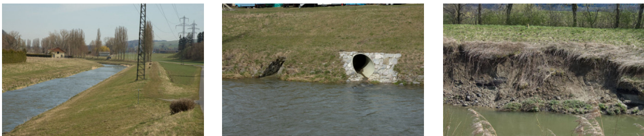
Figure 1: à gauche: lit de la Broye à l'aval de Moudon; au centre: embouchure des affluents de la Broye; à droite: érosion de berge à l'aval du Pont Neuf
